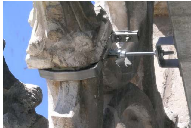
Figura 6. Particolare di una ganascia in corrispondenza di un capitello
