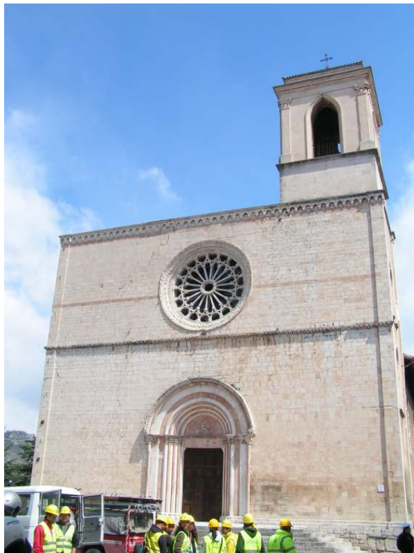
Figura 1. La chiesa di S.Silvestro a L’Aquila dopo il terremoto
