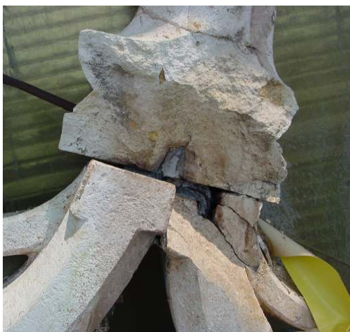
Figura 3. Particolare di un capitello interessato da fratture ed estese mancanze
