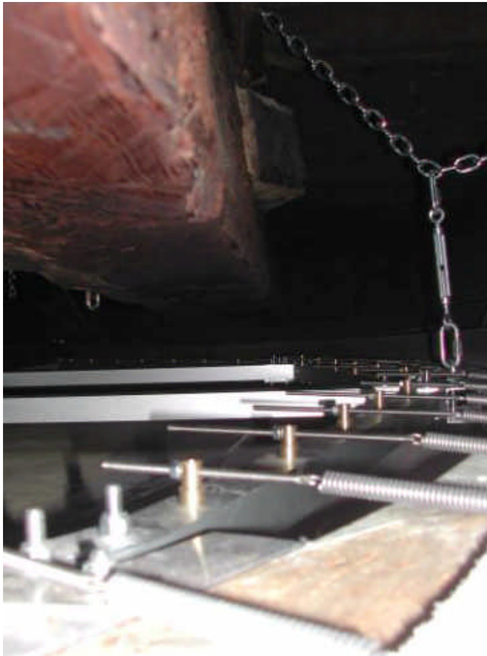
Figura 13 Nell'intercapedine tra dipinto e soffitto: i meccanismi di tensione, la struttura di rinforzo e le catene del vincolo definitivo.
