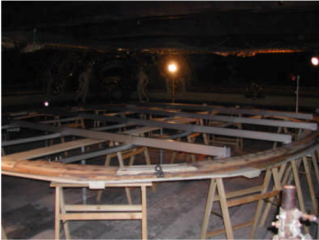
Figura 7 Il telaio modificato, con la nuova struttura metallica di rinforzo.
